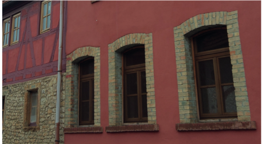
Ortsuntypische Gestaltung der Fassade
