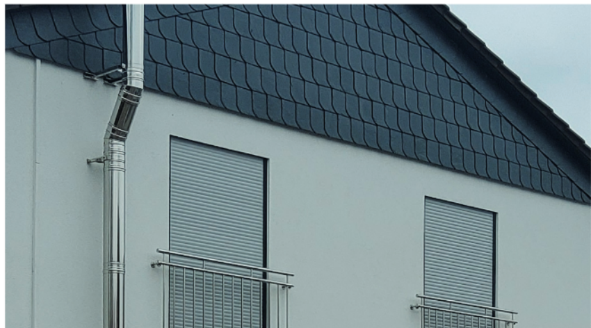
Modernisierungs- und instandsetzungsbedürftiges Gebäude mit geringem Bedarf
