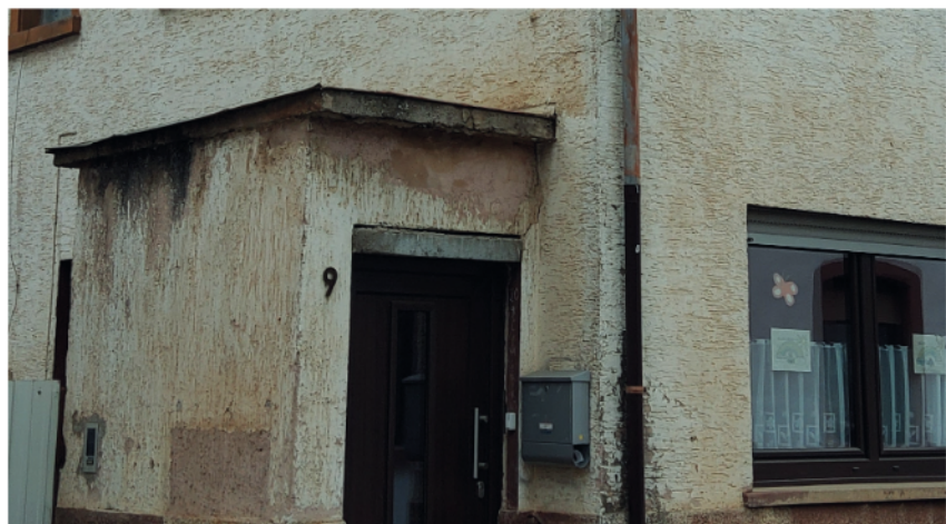
Modernisierungs- und instandsetzungsbedürftiges Gebäude mit hohem Bedarf
