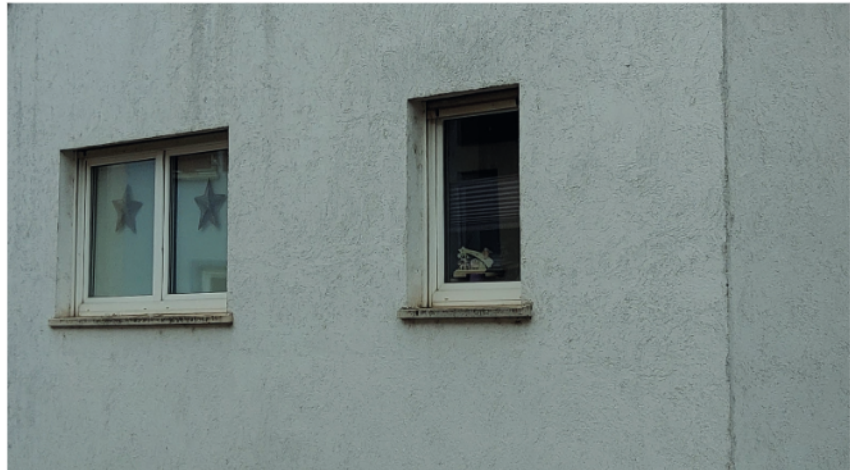
Modernisierungs- und instandsetzungsbedürftiges Gebäude mit mittlerem Bedarf
